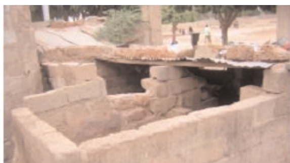
Figure 5 : Logement du type C en parpaing sans dispositif d'évacuation du purin
